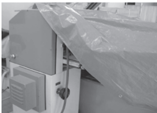
写真2 長期間使用していない装置
